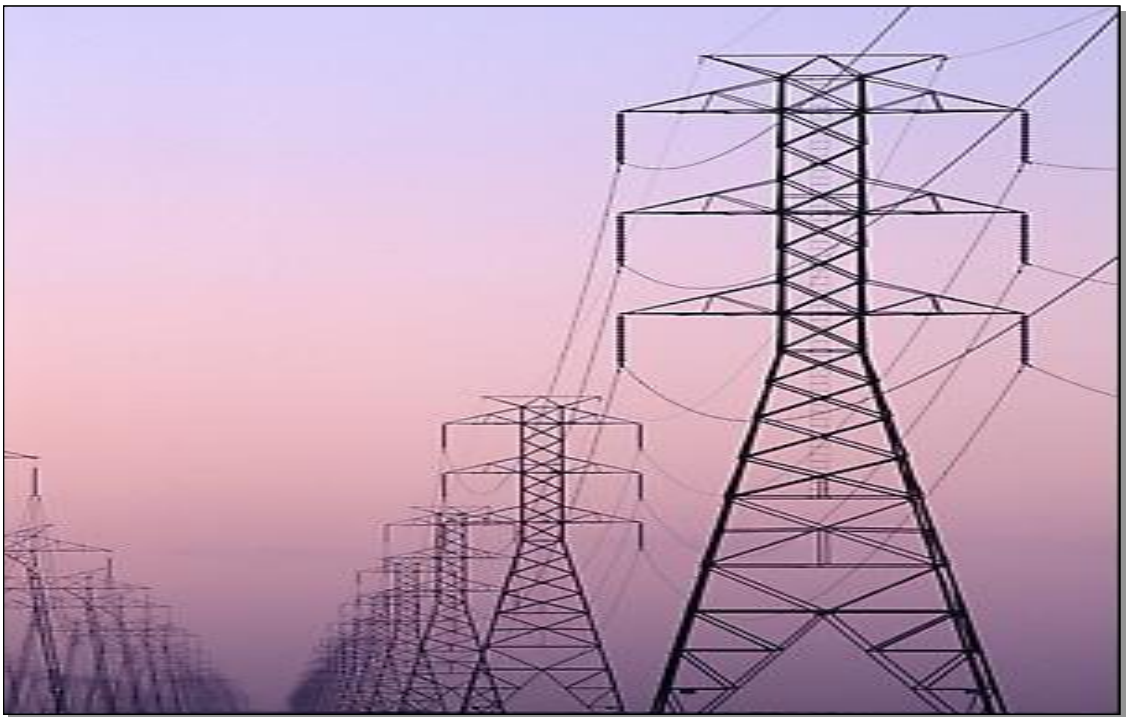
Hình ảnh các đường dây truyền tải điện cao thế
